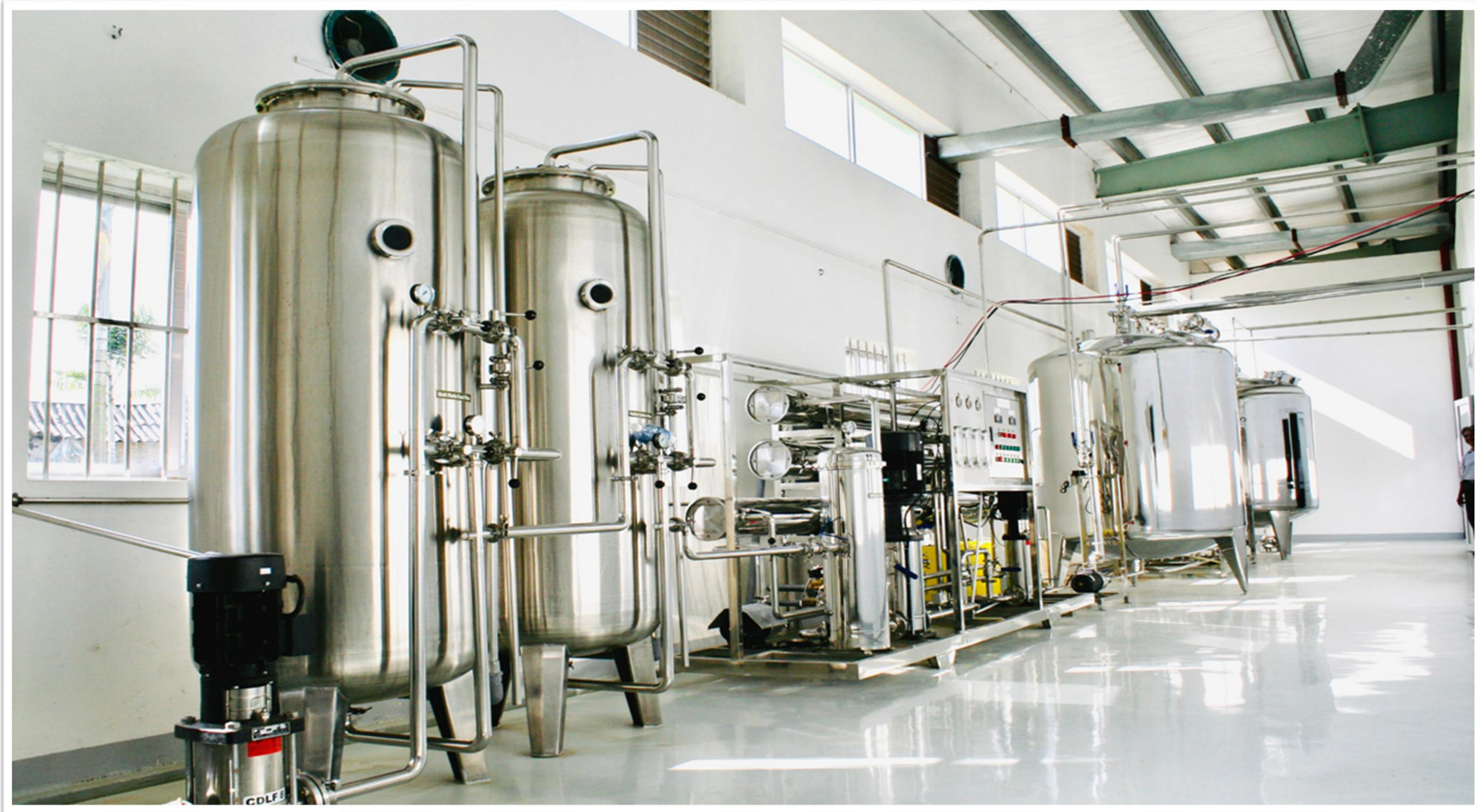
Hệ thống xử lý nước RO và nước cất
